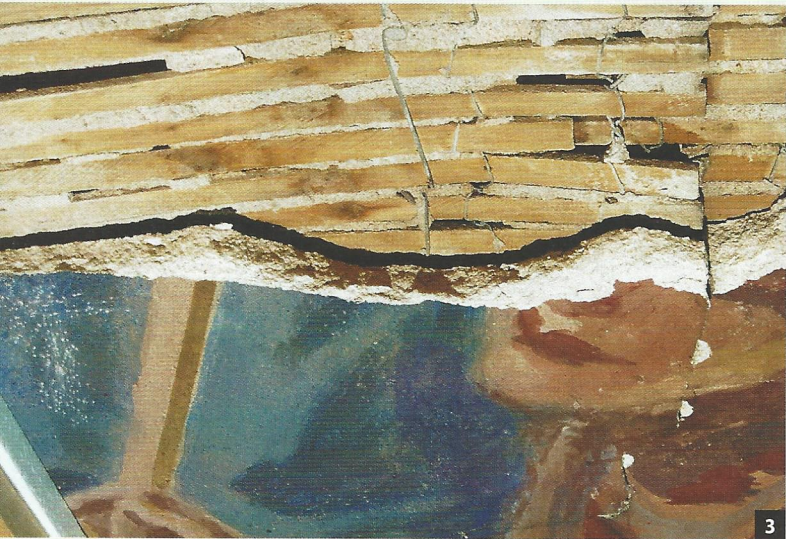
Abb. 3: Durch Fehler in der Ausführung lösten sich große Teile des Freskos vom Putzgrund.
