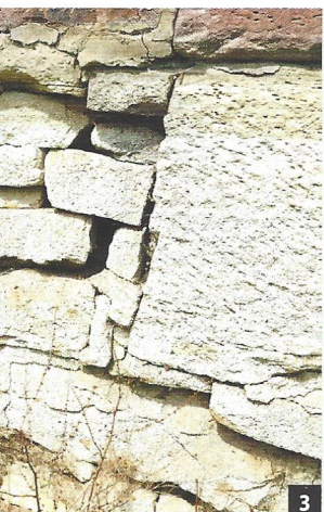
Abb. 3: Das Mauerwerk hatte sich auf Höhe des Wasserspiegels in Richtung Becken verschoben.
